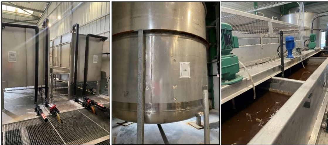
Figure 4. Photographies de la station de traitement des eaux (à gauche : les bacs déshuileur-déboureur ; au centre : cuve à boues ; à droite : contrôle pH)
